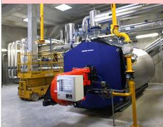
Centrale thermique de Rixheim
